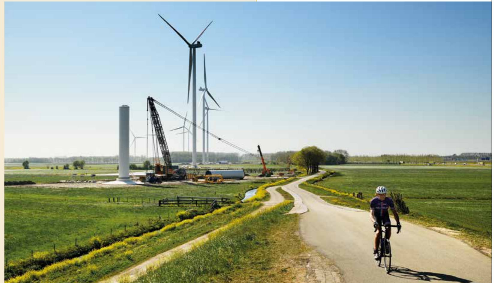
Bouw van een nieuwe windturbine bij Waardenburg. | Foto Bart van Overbeeke, Hollandse Hoogte
